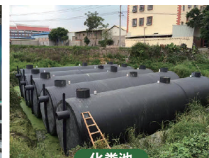
化粪池 Septic Tank
